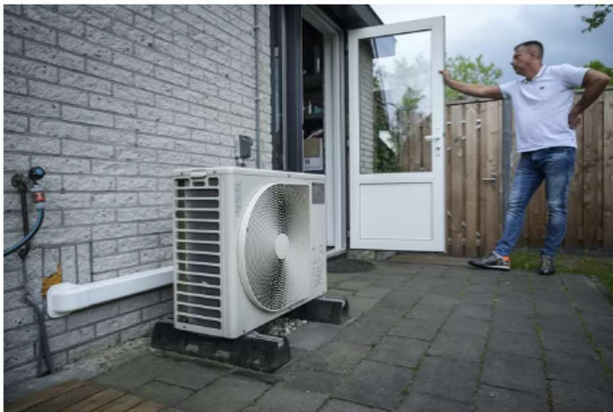
▲ De buitenunit van een warmtepomp. ©ANP
