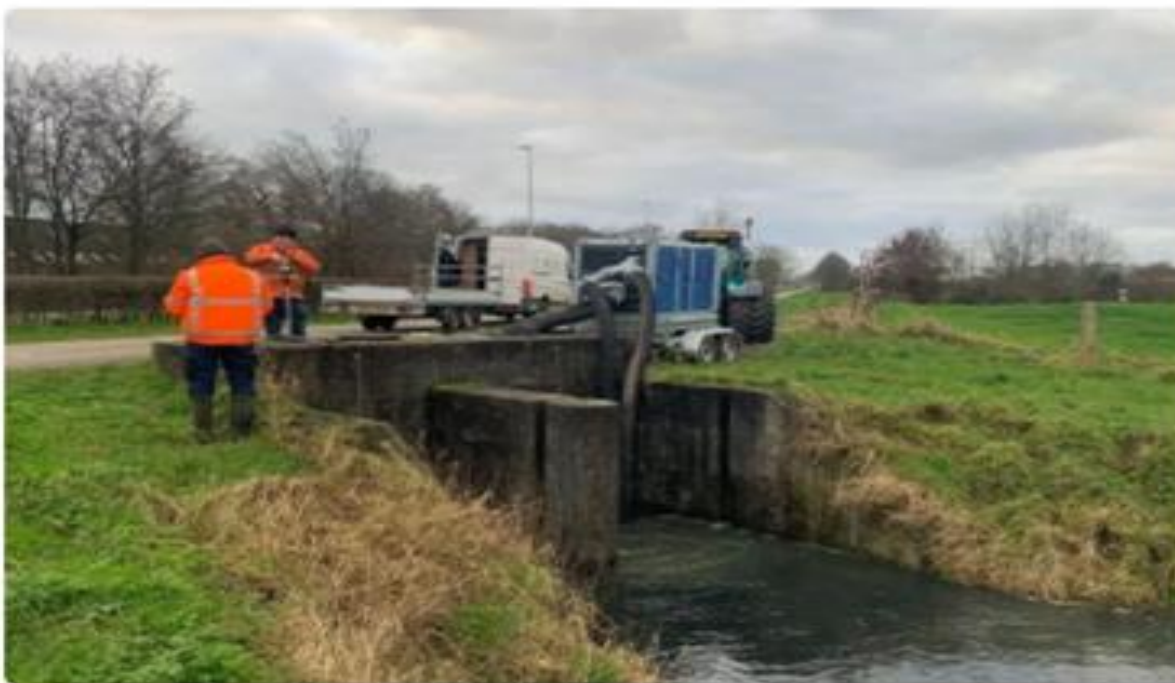
Pomp geplaatst bij de Huet © Waterschap Rijn en IJssel
