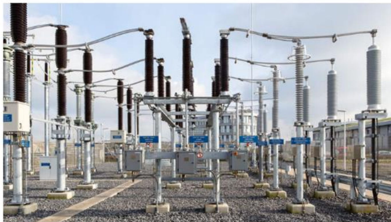
Een schakeltuin van Enexis en Tennet. © Enexis
